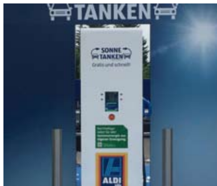
Schnellladestation bei Aldi Süd
